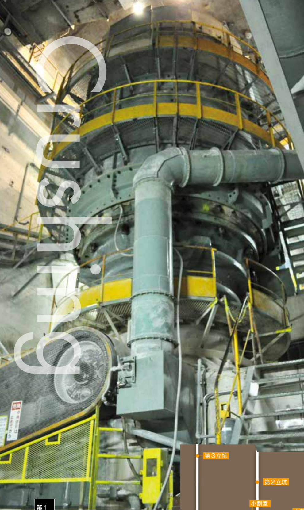
第1立坑 破碎機(ジャイレトリークラッシャ)
